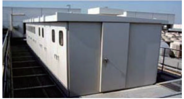
6KV 受電設備 (於：紙加工工場)
